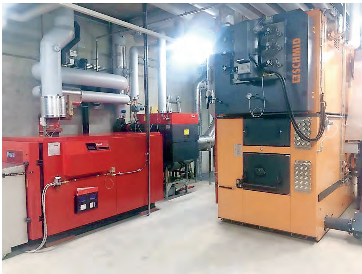
Der Heizkessel der BGS
